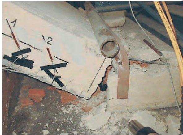
Fig. 9 - pannello n. 5 con laterizi Cat. B. Panel no. 5 with clay elements Cat. B.
